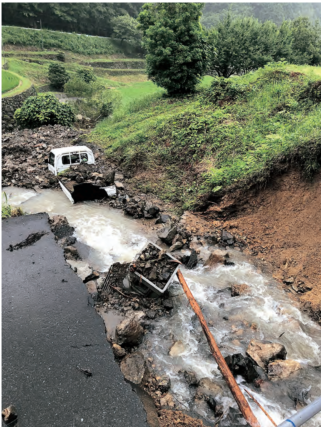
鬼北町 水路の氾濫により町道久保川線が損壊
